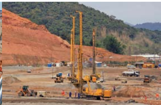
Execução de colunas de brita para reforço do pátio de estocagem de minérios
