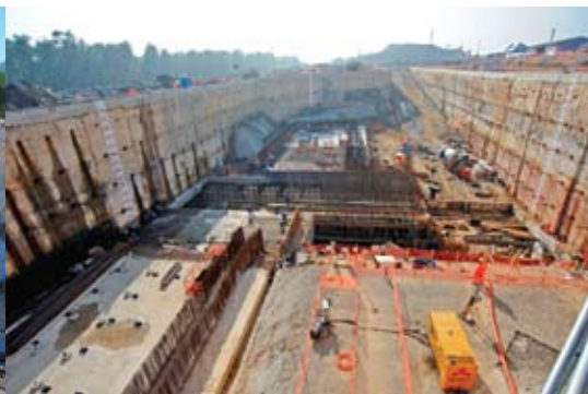
Virador de vagões: armação da laje de fundo com taxa de aço de 300 Kg/m 3
